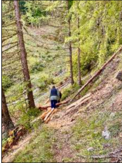
Die Baustelle zum Entrinden der Baumstämme und Zuschneiden der Pfosten und Latten.
